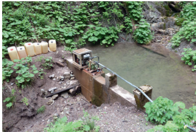
Abb. 28: Alte Trinkwasserfassung mit Benzinmotor
